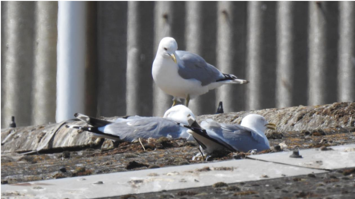
Abb. 11.7: Bremen, Industriehafen, Waterbergstraße, Dachbrut der Sturmmöwen auf bemoosten Eternitplatten, 11.05.2022, G. Lühning
